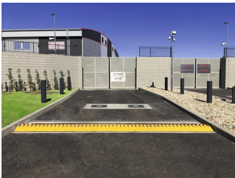
Fot. 4: Kolczatki drogowe umożliwiają przejazd pojazdów tylko w jednym kierunku. Przez przebicie opon blokują ruch w kierunku przeciwnym.
