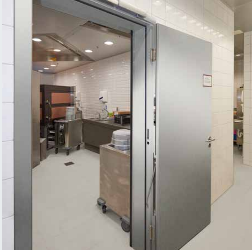
Funcionamiento diurno con puerta cortafuego abierta
