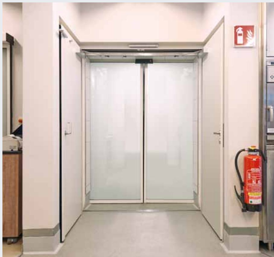
Face visible de l'extérieur de la porte coupe-feu et anti-fumée (fonctionnement jour)
