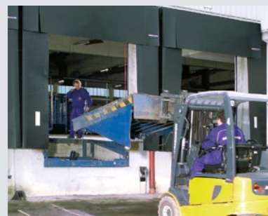
Demontaža starog utovarnog mosta, eventualno prilagođavanje rova (npr. montažnim pločama ili konzolama)
