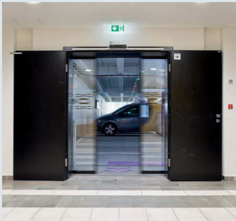
Ansichtsseite Feuer- und Rauchschutztür (Tagbetrieb)
