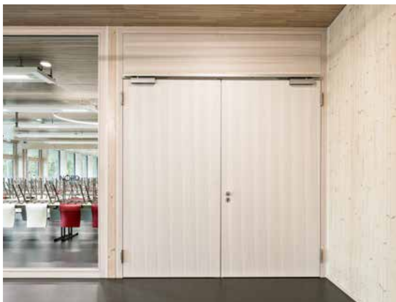
Двустворчатая противопожарная дверь при входе в столовую.
